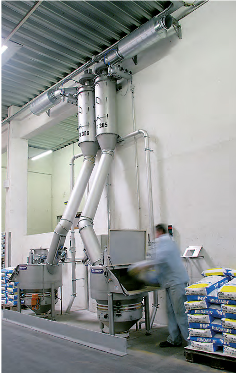
◀ Abb. 1: Kombinierte Sack- und Big-Bag Aufgabestationen mit Kontrollsiebmaschine KS700, Aspirationssystem mit Radialventilator und Düsenfilter
